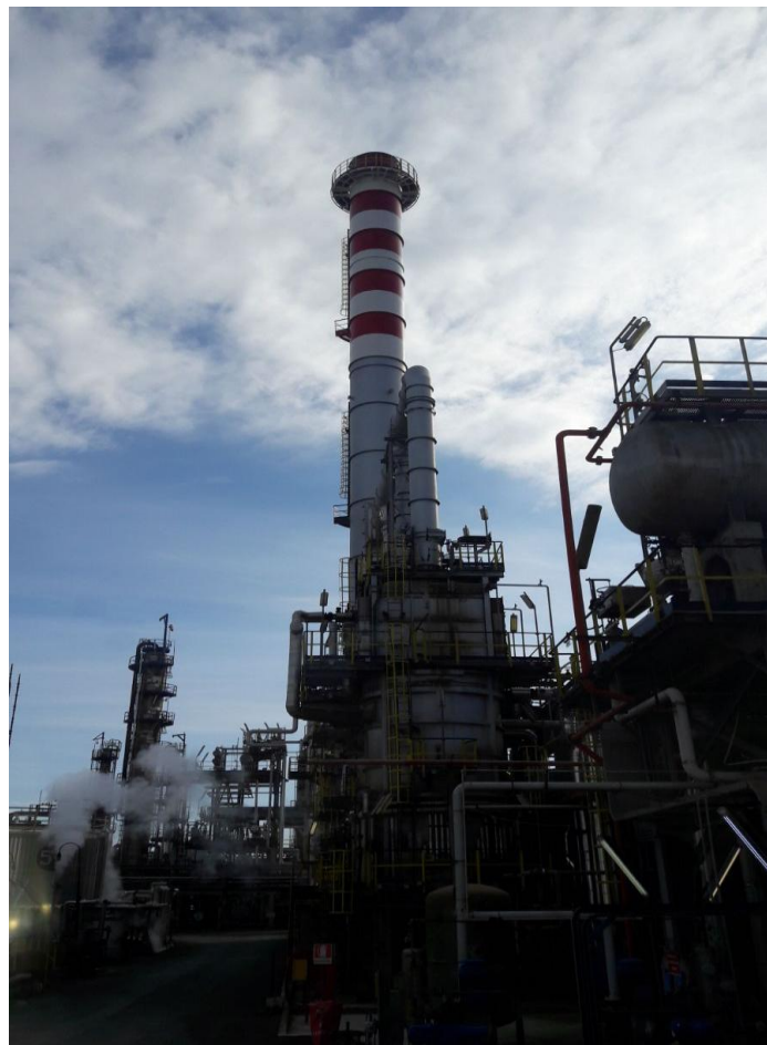
Impianto di reforming
