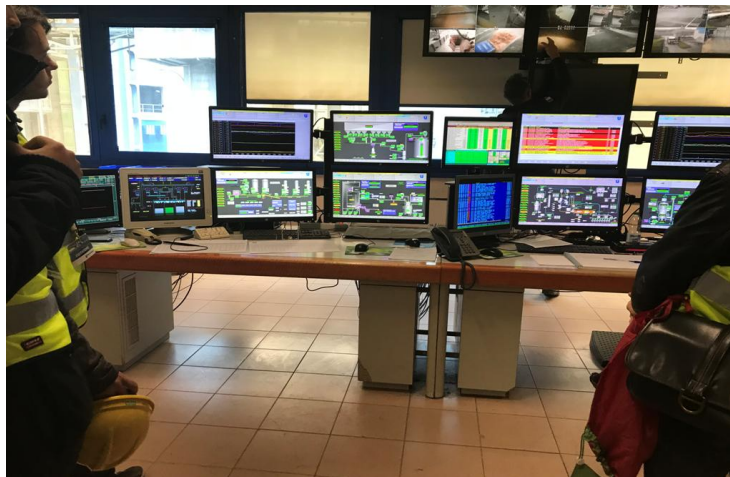
Sala di controllo
